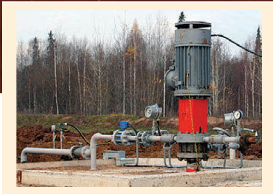
Рис. 3. Наземное оборудование УНУ ППД на скв. 347 Москудьинского м/р ООО «ЛУКОЙЛ-ПЕРМЬ»
